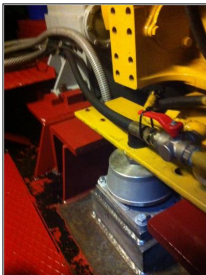
Figuur 4.4.5: motor Melvin opgesteld op trillingsisolatoren
